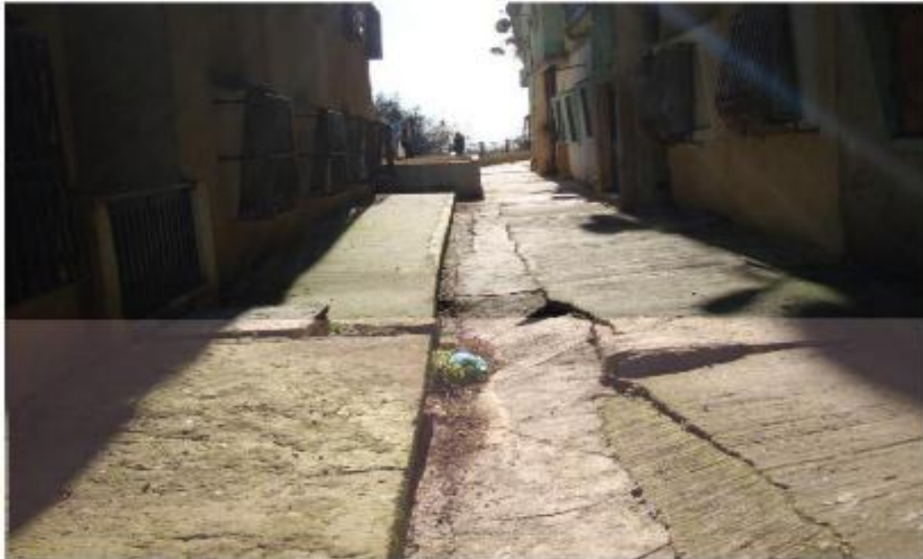
Figure .I.11. Affaissement du dallage entre les bâtiments en Sidi Youcef Béni Messous Alger [ 22 Mars 2011 ].
