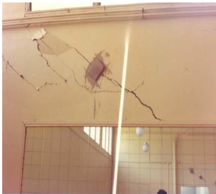
Figure 1.16 Tassement différentiel du terrain sous Les fondations d'une station de pompage (Benaissa 2011)
