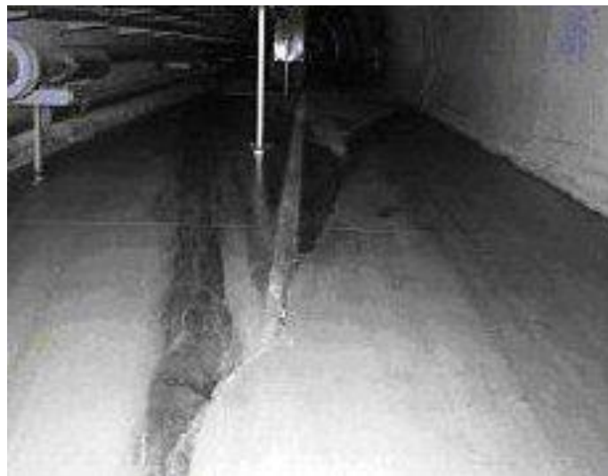
Figure 1.22 Soulèvement puis dislocation du radier d'un tunnel (Benaïssa 2011)
