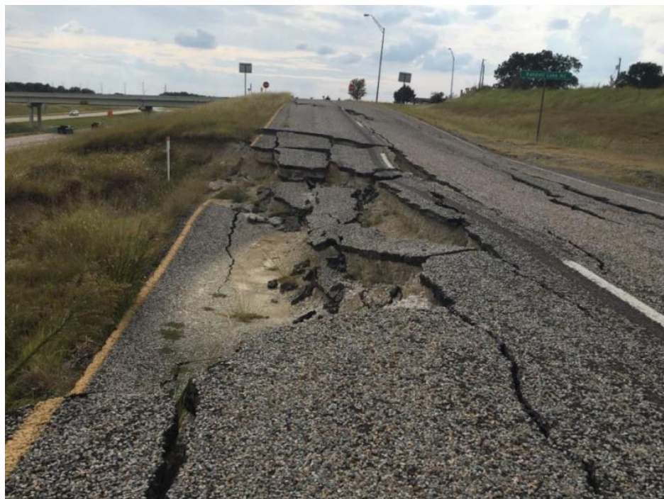
Figure 1.19 Dégâts causés par le gonflement des sols expansifs (Puppala 2021)
