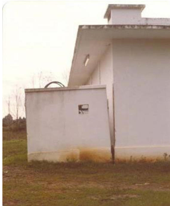
Figure 1.17 Hôpital Moulay Ismaïl, (Meknès) dégradations dues au gonflement du sol (Benaïssa 2011)
