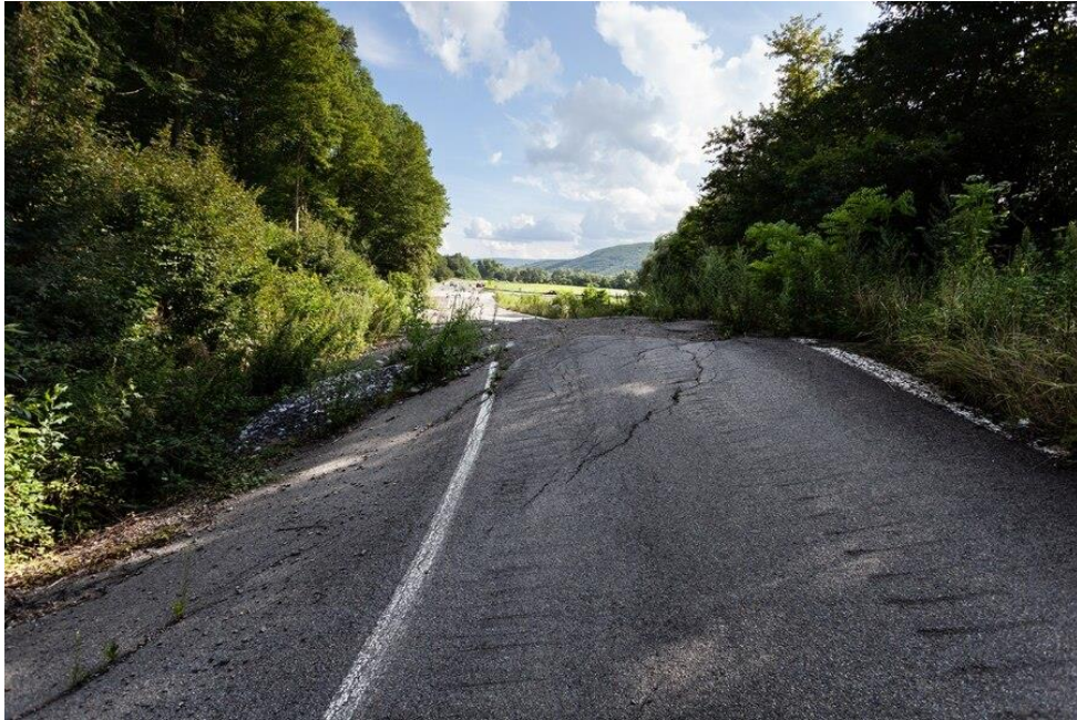
Figure 1.20 Asphalté gonflé (Palinchak 2010)
