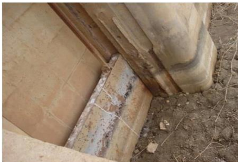
Figure ( 1. 5) : Blocage de la vanne de fond de la deuxième digue du barrage Boughezoul. Reminiet al., (2011)
