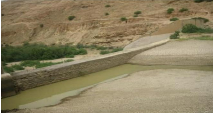
Figure (1.2) : Envasement des barrages. Remini ., (2012)
