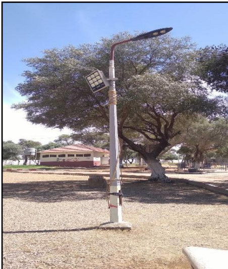
Figure n°81 : Poteaux d'éclairage traditionnel
