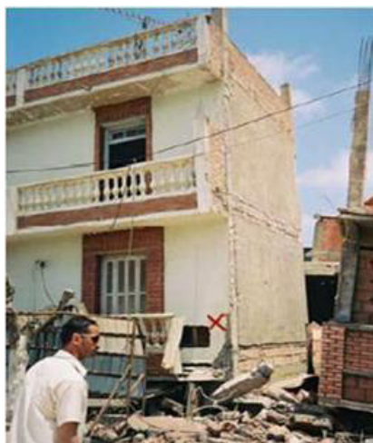
Figure 1.10 : Effondrement d'un bâtiment d'habitation individuel à cause de la défaillance des poteaux de l'étage souple, Boumerdès 2003
