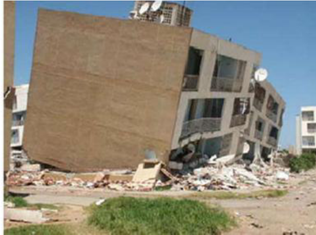
Figure 1.9 : Effondrement complet d'une construction au niveau 1 Boumerdès 2003.
