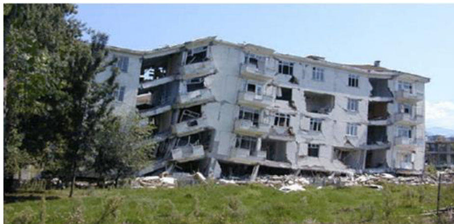
Figure 1.21 : Effondrement d'un bâtiment en maçonnerie avec grande ouverture à la base (Badoux 2000)
