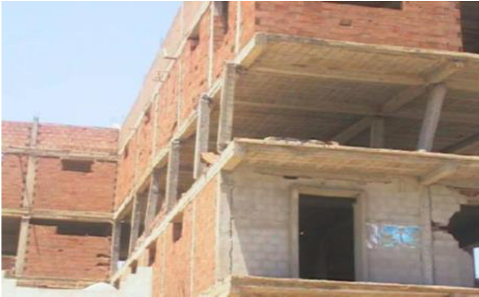
Figure 1.26 : Etage supérieur souple Séisme de 2003, Boumerdes (Djafer Henni 2024)
