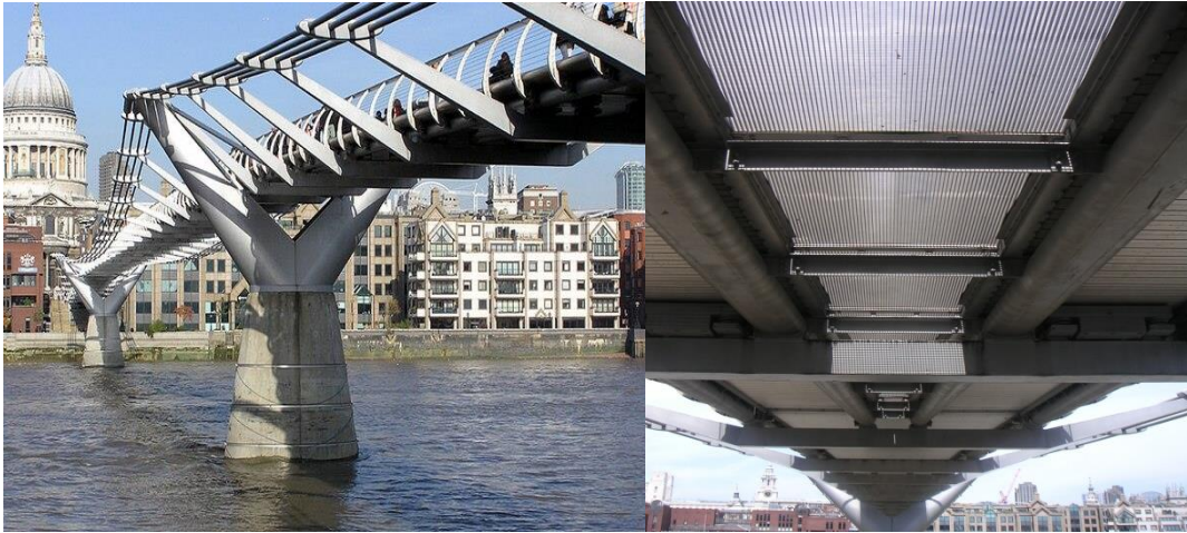
Figure. 1.16- AMA verticaux installés sous le tablier de la passerelle du Millenium à Londres.
