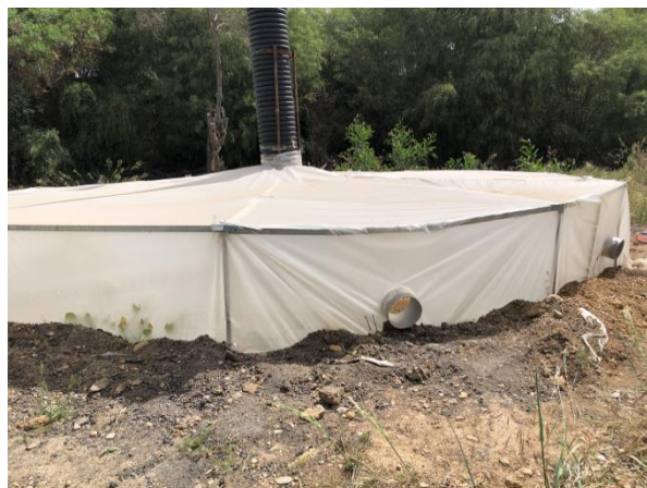
Figure IV.1. Photo des ouvertures d'entrée de l'air dans le collecteur
