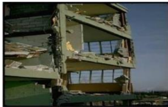
Figure I.4 : Dislocation des remplissages de maçonnerie.[1]
