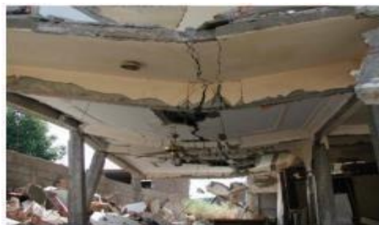
Figure I.3 : Rupture par flexion des poutres.[1]
