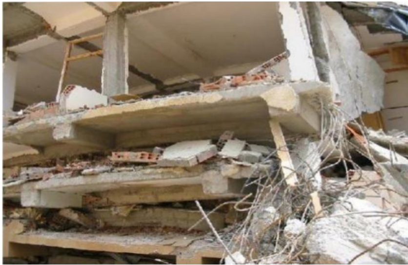
Figure I.7 : Effondrement total de la structure. [5]
