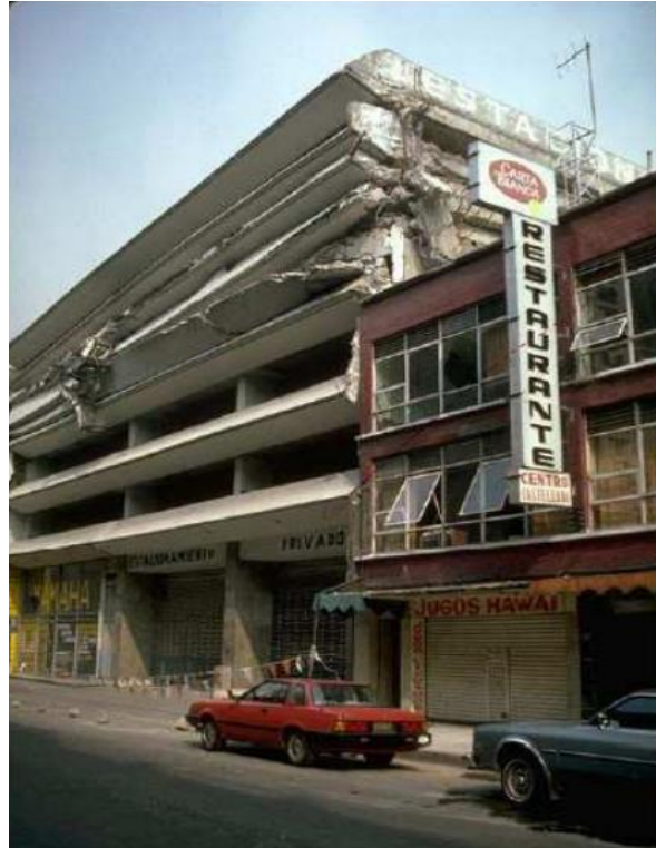
Figure 1.13 : Dommage dus à la présence de niveaux en retrait.
