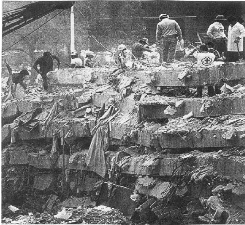
Figure 1.23 : Effet de la ruine de poteaux faibles : l'empilement des planchers après séisme (Hamas 2010).
