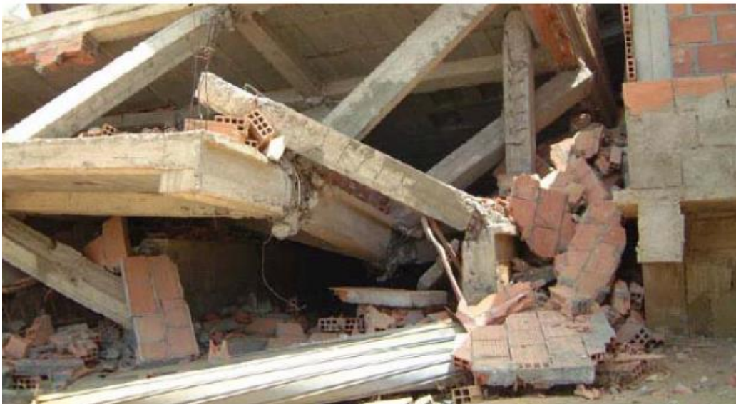
Figure 1.26 : Ossature en portique de béton armé en construction et effondrée (Boumerdes, 2003) (Hamas 2010).
