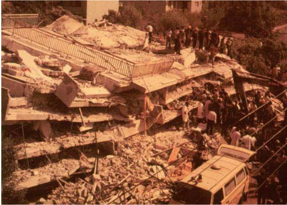
Figure 1.25 : Rupture fragile des poteaux (Blandier 2004).
