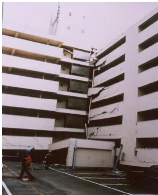
Figure 1.11 : Dommages sismiques occasionnés aux bâtiments comportant des ailes.
